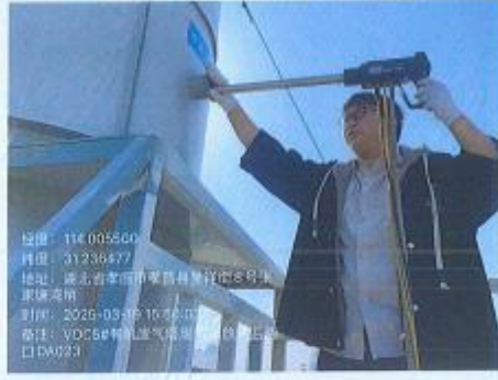
VOC5#有机废气塔废气排放筒监测口 DA023
