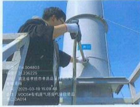
VOC6#有机废气塔废气排放筒监测口 DA014
