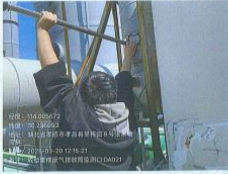
成型集成排气筒监测口 DA021
