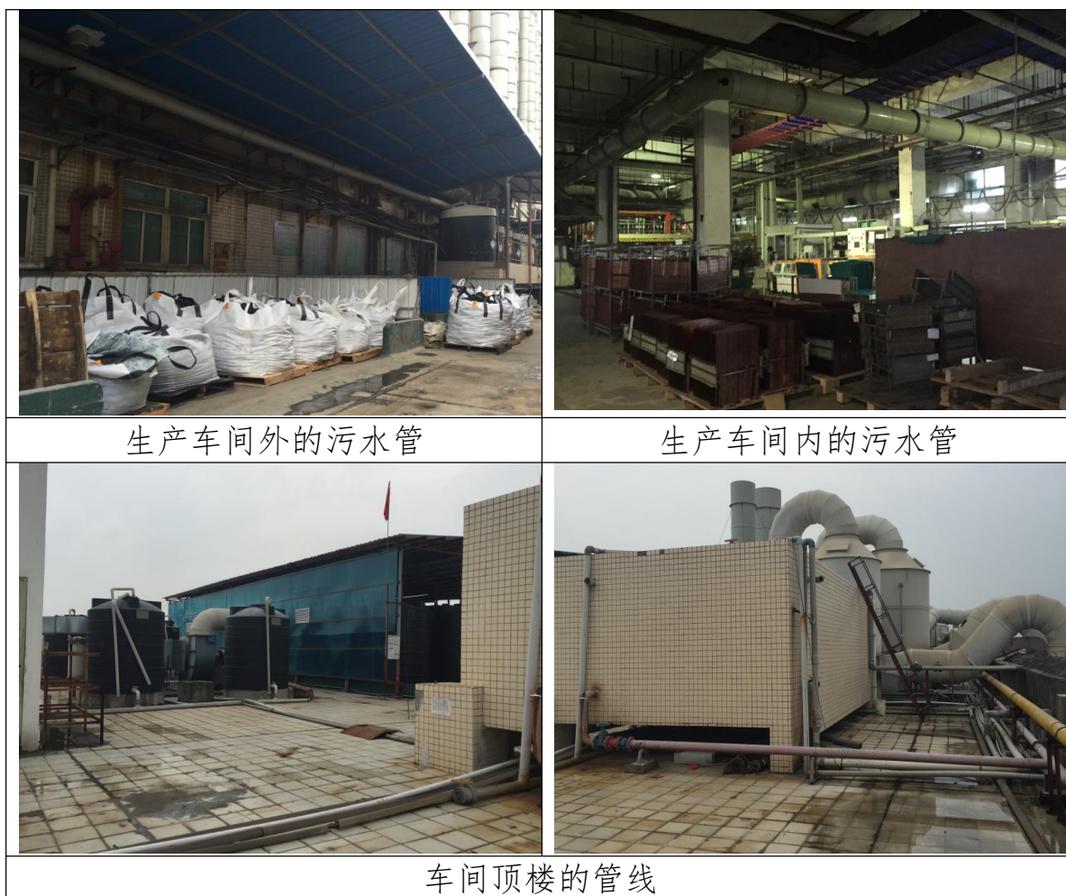
图 4.1-3 生产废水管道现场照片
