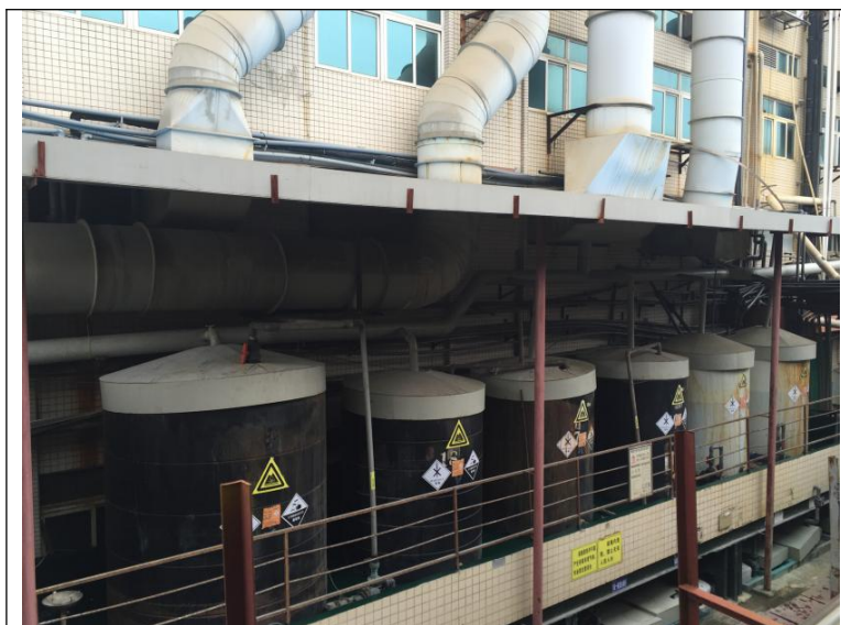
污水站内的次氯酸钠溶液罐
